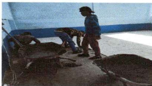
Foto 5: Sustitución de Pisos en mal estado.
